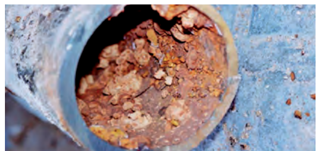
TUBERÍA DE SANEAMIENTO CON DEPOSICIONES DE MATERIAL.
