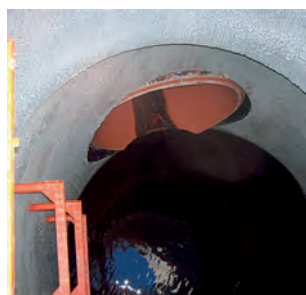
FALTA DE ESTANQUEIDAD EN POZOS DE HORMIGÓN.
