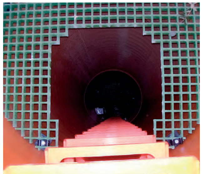
TRAMEX DE POLIÉSTER EN POZOS SANECOR®.
