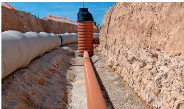
COLECTOR Y POZOS SANECOR® PARA AGUAS RESIDUALES JUNTO A COLECTOR DE PLUVIALES EN HORMIGÓN.
