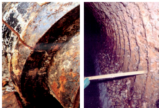
EFFECTOS DE LA CORROSIÓN EXTERIOR E INTERIOR EN TUBERÍAS.
